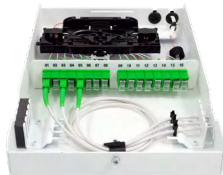
Zone de connexion des câbles préconnectés venant des bureaux
