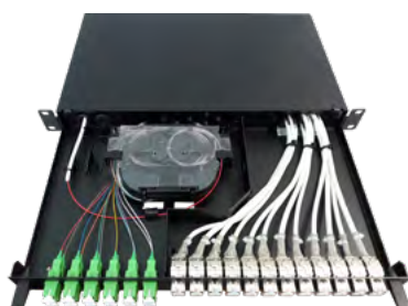
Tiroir équipé d'une cassette 12 épissures
