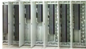
IBER-C-603-RES-COM installées sur site
