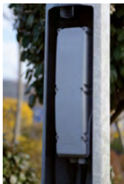
Installation en candélabre
