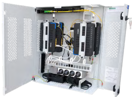
Coffret équipé de 4 convertisseurs électro-optiques
