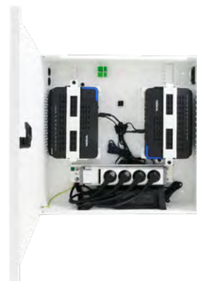
Coffret équipé de 4 convertisseurs électro-optiques
